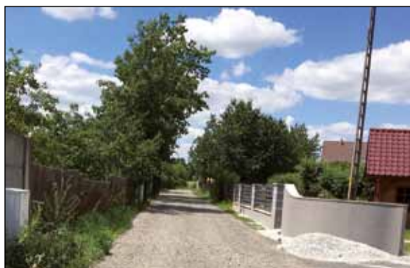
Zrealizowano pierwszy etap drogi dojazdowej w Męcince. Wykonana podbudowa stanowi przygotowane podłoże do warstwy asfaltowej
